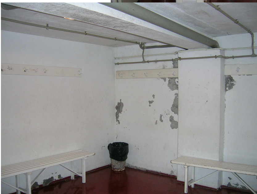
Foto 6 Detalle do estado dos tabiques dos vestiarios.
