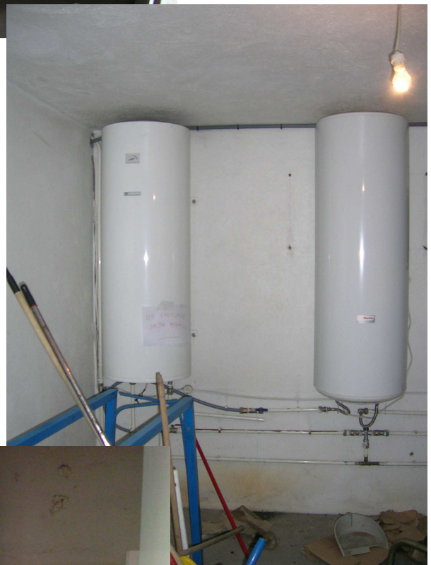
Foto 8 Vista da instalación de auga quente.
