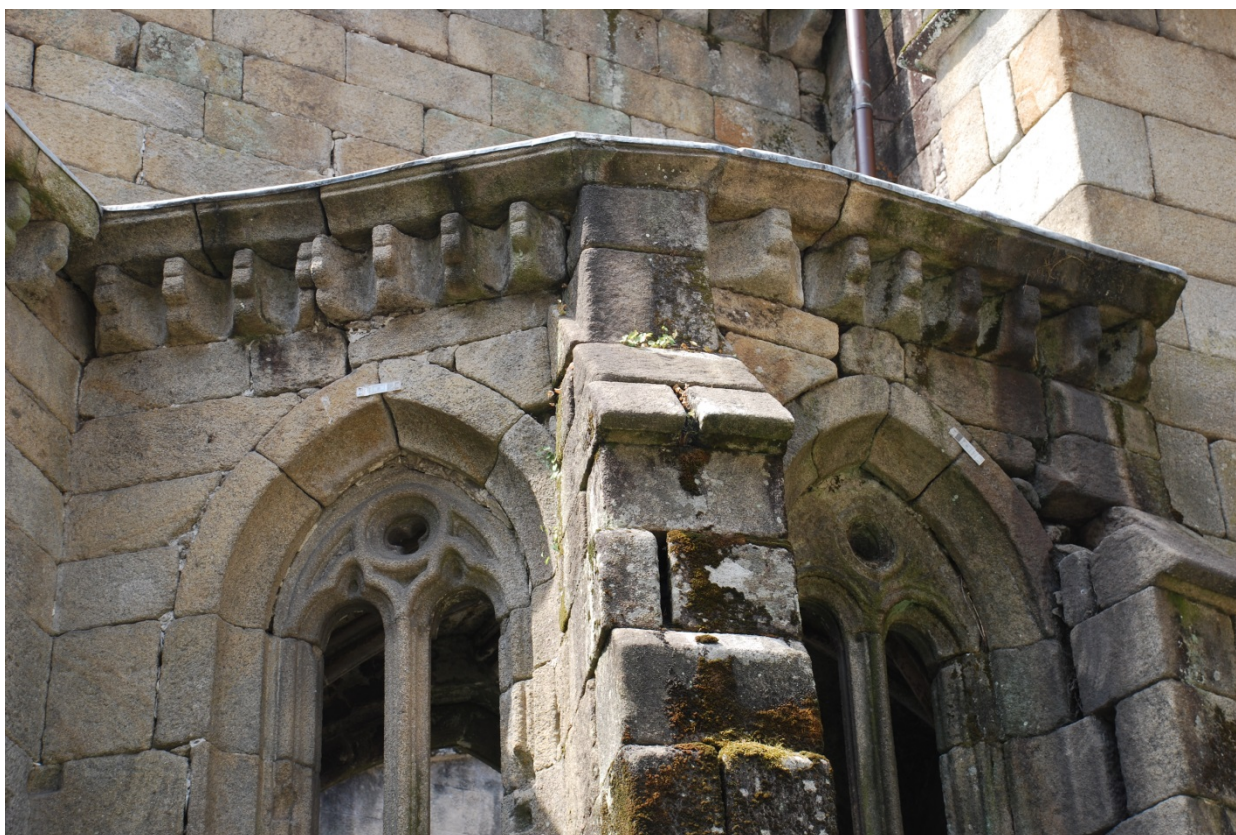
Figura 18: la pérdida de juntas es importante en toda la fábrica, en la que, además, se producen desplazamientos de sillares. En algunas de estas aberturas están colocadas regletas de seguimiento que se mantienen íntegras (desconocemos la fecha de colocación).
