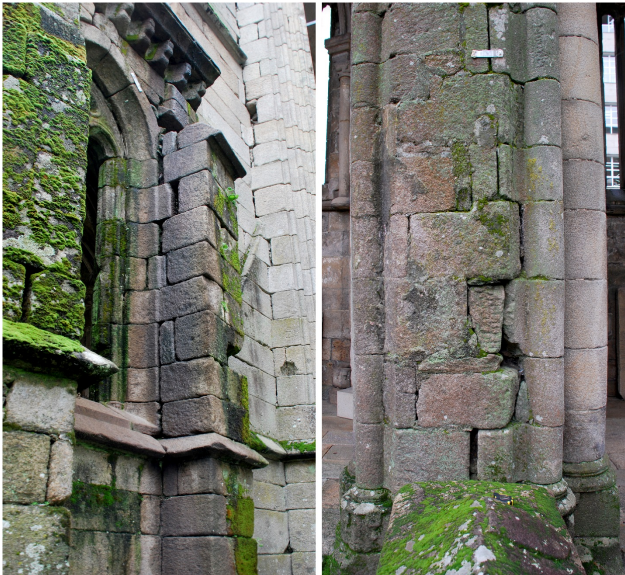
Figura 20: detalles de las grietas producidas por separación de sillares.
