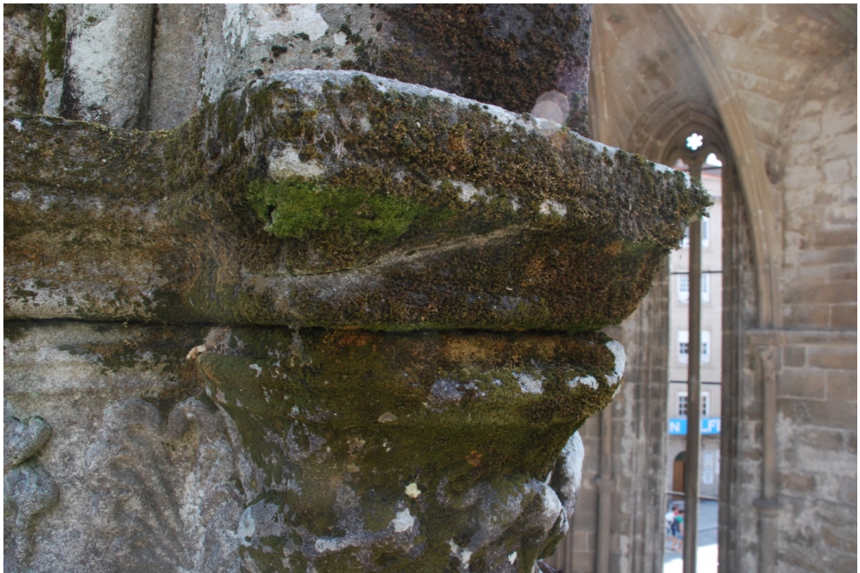
Figura 21: las juntas de la cornisa, en general, están perdidas. También se detectan algunas fisuras cuyo interior debe estar colonizándose, por lo que es imprescindible limpiarlas y sellarlas.
