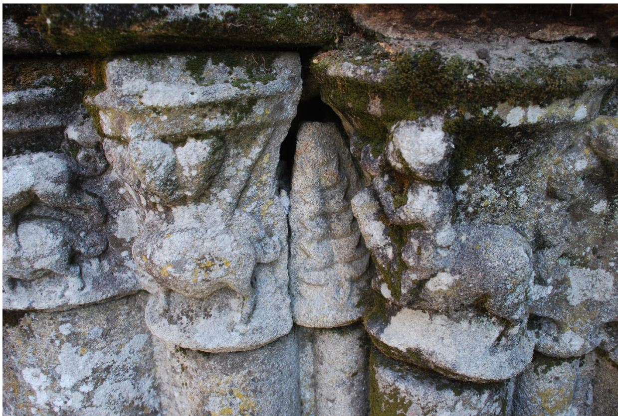
Figura 19: el desplazamiento de las fábricas y la falta de mantenimiento han generado grandes huecos que suponen vías de agua y retención de humedad en su interior.
