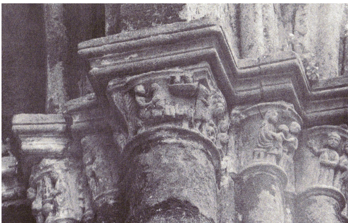
Figura 23: fragmentación del capitel que derivó en el cierre de la ruina al público. En la fotografía de principios de la década de 1990 (Manso Porto, 1993:541) ya se ve una fisura en el capitel, coincidiendo con la junta del cimacio. El capitel roto representa parte de la escena de la Adoración de los Magos, en concreto a la Virgen sentada sobre un taburete con el Niño en sus rodillas, adelantándose a coger la ofrenda del rey Melchor.
