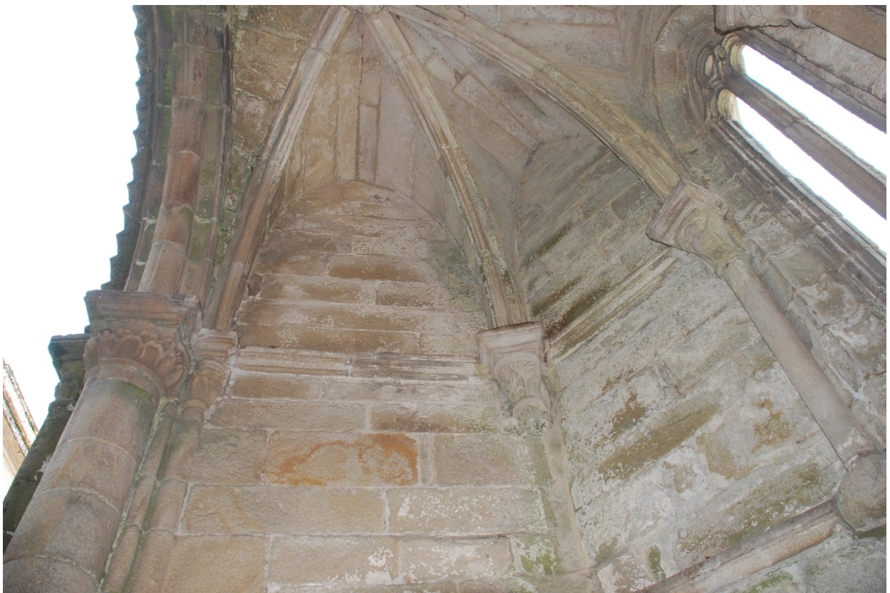
Figura 17: restos de enlucido en la segunda capilla del Evangelio (1) y segunda de la Epístola (5). En algunas zonas parece que se están formando cristalizaciones salinas originadas por la disolución y recarbonatación de la cal.
