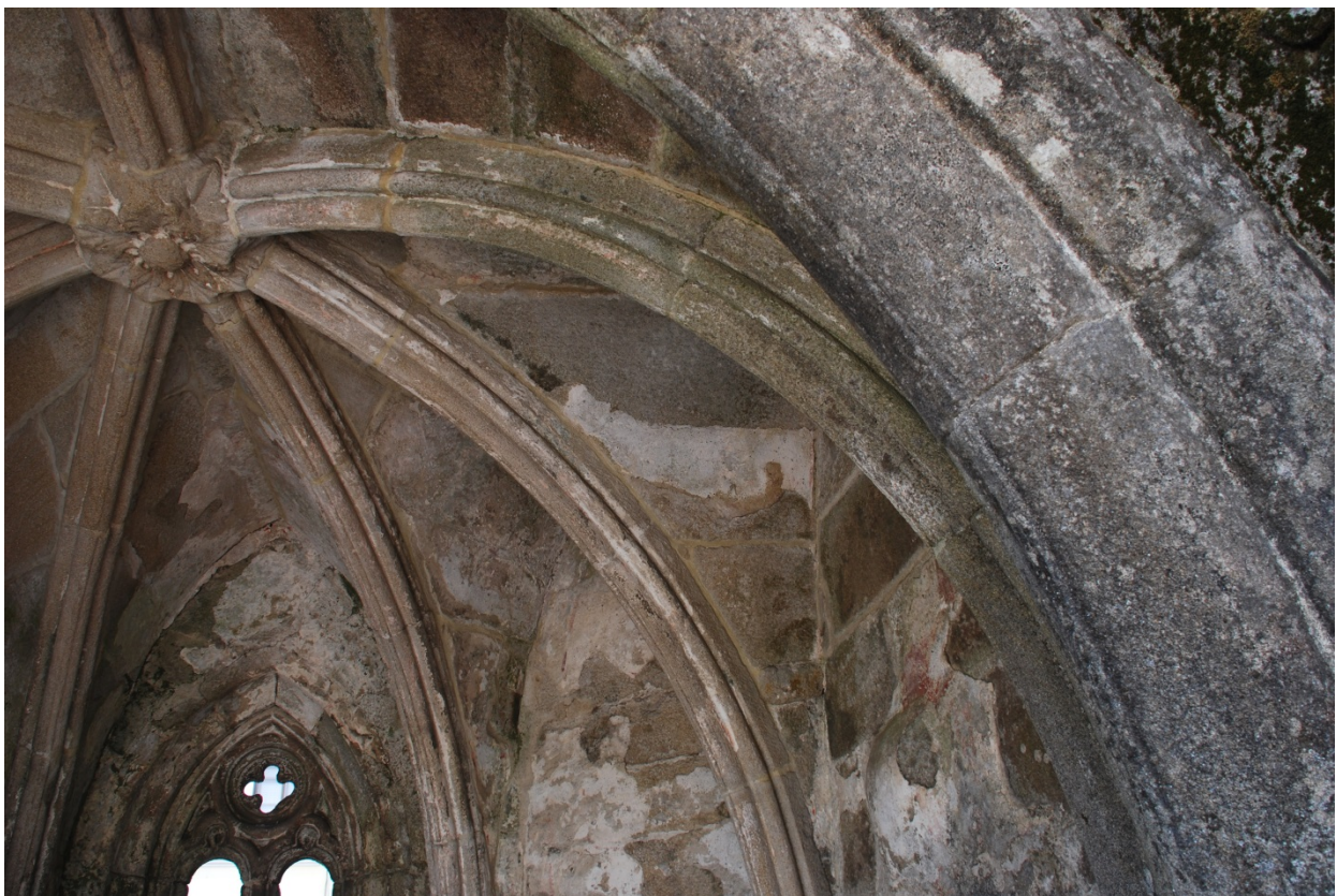
Figura 16: En la primera capilla del Evangelio (2), según constancia documental, existieron pinturas murales, parcialmente conservadas cuando colapsó el edificio. Ahora se ven restos de enlucado y morteros, en proceso de desprendimiento; aun así, en la bóveda parece que asoman restos de color rojo.
