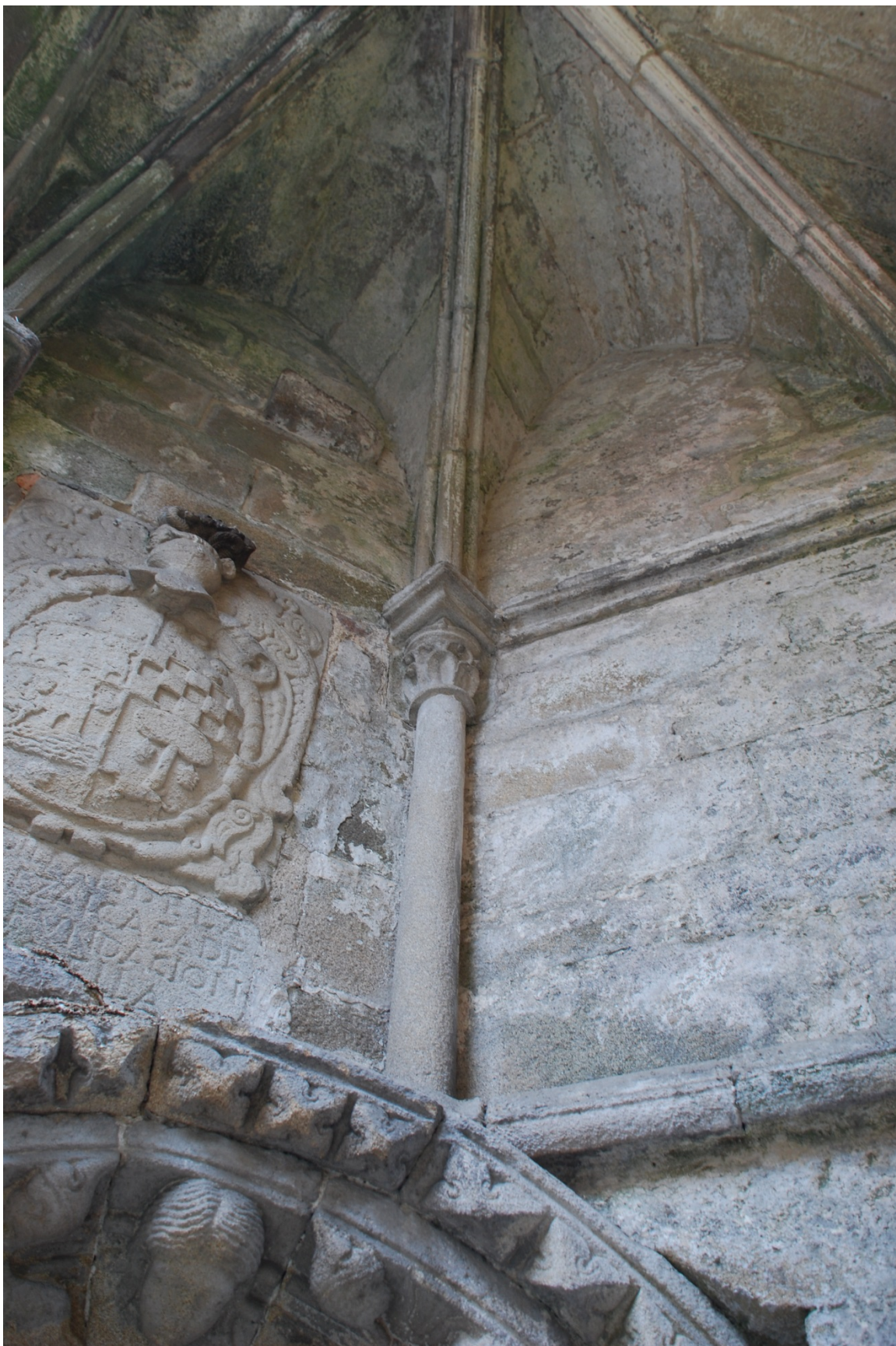
Figura 15: todas las capillas (capilla mayor/3) conservan restos de encalado, bajo el que es posible que queden restos de revestimiento con pintura. También caber la posibilidad de encontrar vestigios de policromías en los escudos, capiteles y otras tallas.
