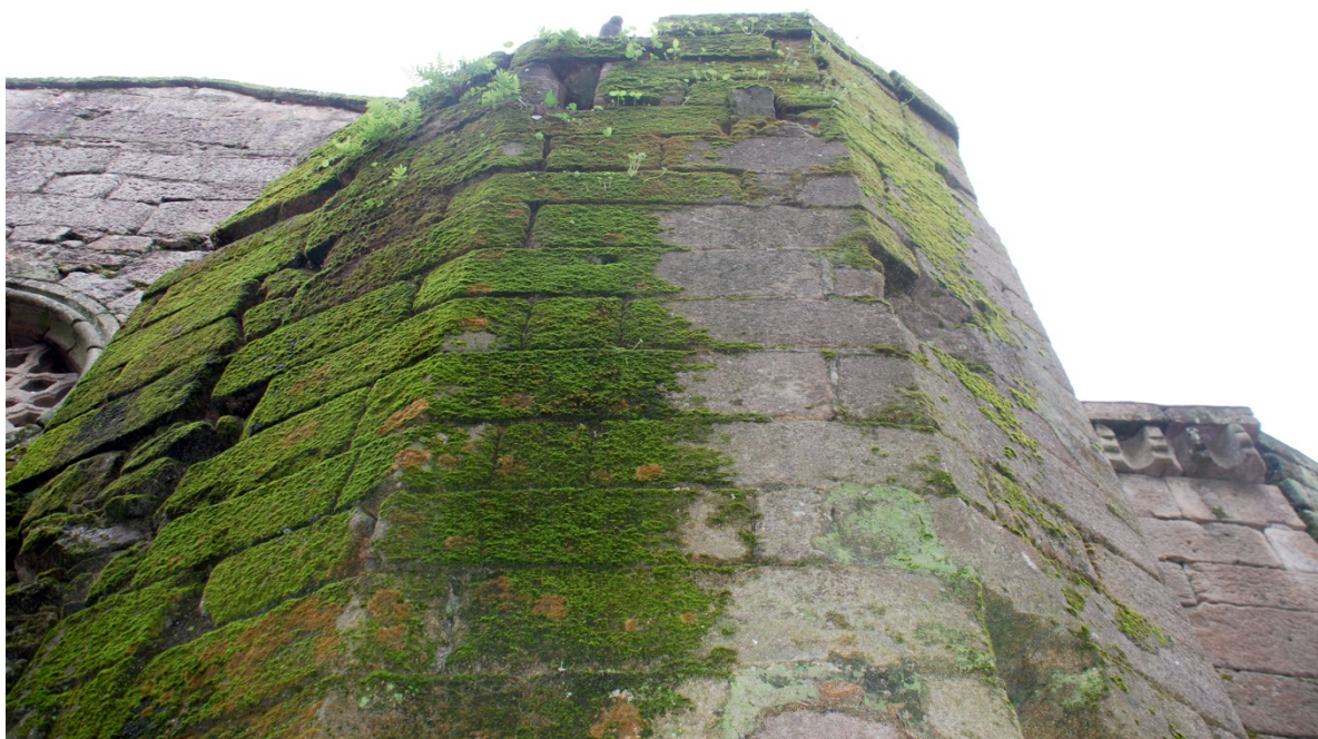
Figura 11: la colonización de musgos afecta a una buena parte de las fábricas lo que hace que éstas permanezcan mucho tiempo húmedas, la pérdida de juntas y las oquedades facilitan la colonización biológica: crecimiento de plantas y refugio de aves.
