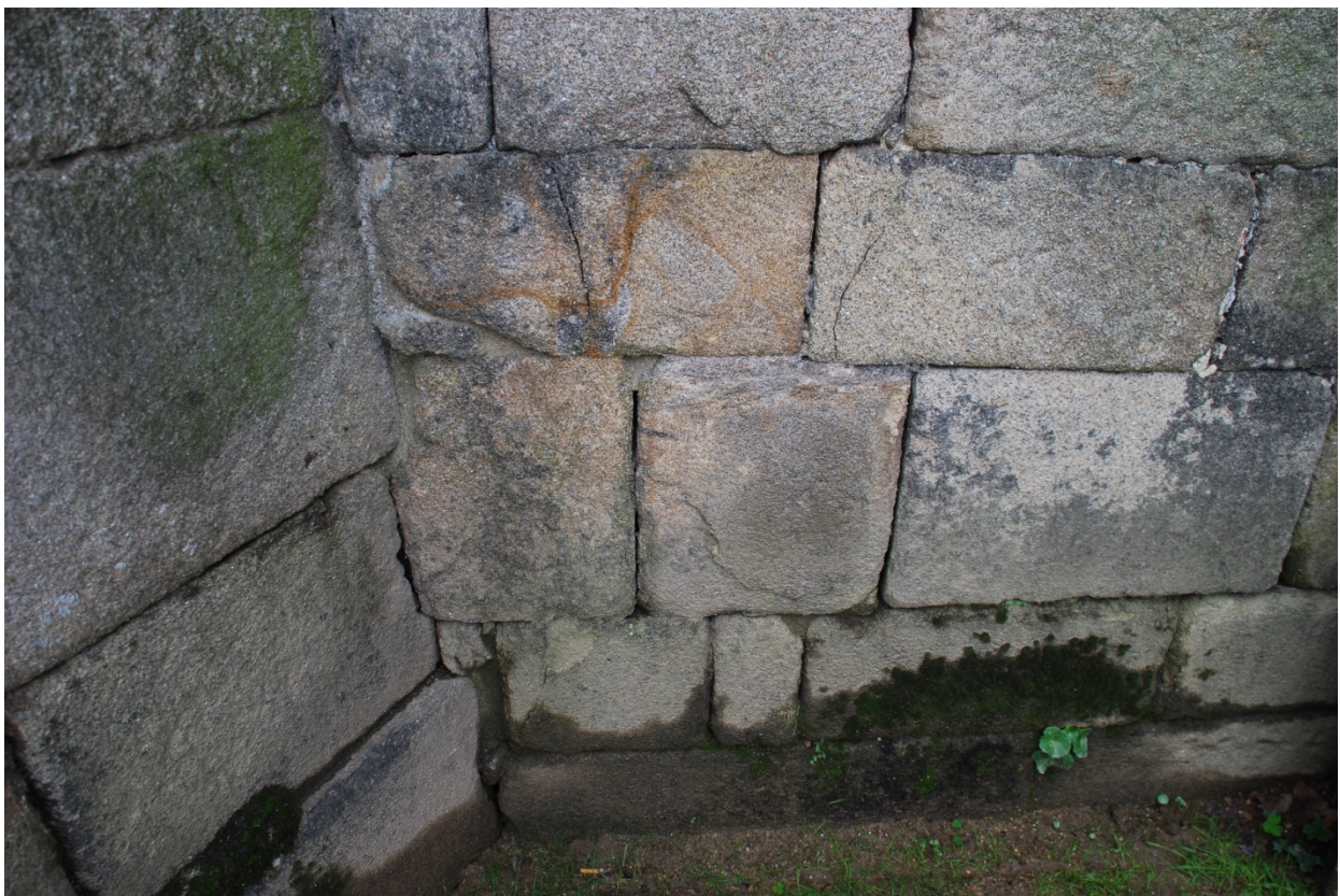
Figura 13: la humedad de ascensión capilar está causando estragos en las partes bajas del edificio: manchas de humedad, costra negra, alteración cromática, pérdida de juntas, descamación, deplacación y fisuras. Es necesario retirar la jardinera y reponer las juntas, además de valorar la conveniencia de hacer drenajes.
