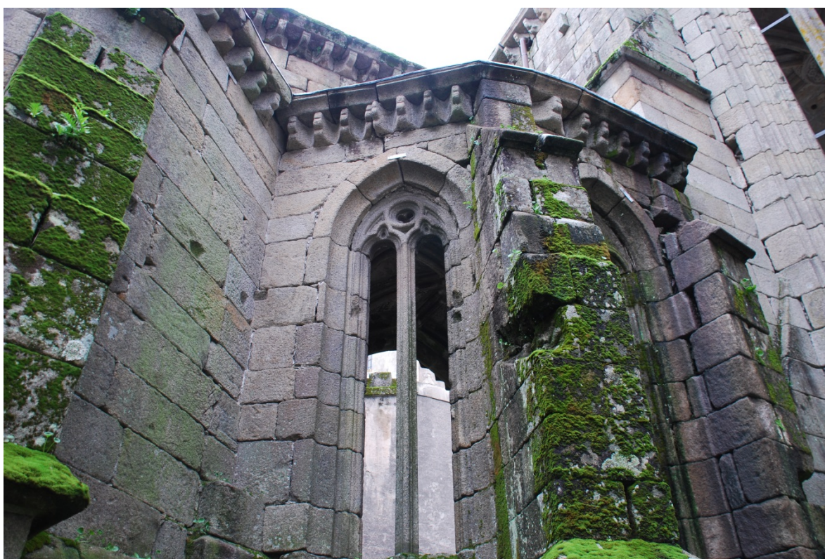
Figura 22: en las fábricas se detectan varios faltantes (partes perdidas). En el caso de la capilla mayor debe ser por la retirada del retablo de la Quinta Angustia . En la fase de estudio habrá que valorar la conveniencia de realizar injertos.
