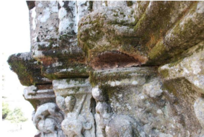
Figura 25. Hueco en la imposta sobre el capitel izquierdo del ábside 3
