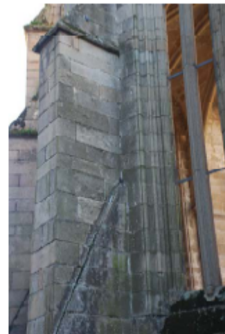
Figura 4.21. Vista de los efectos de las escorrentías en la fachada exterior y en ventanas.
