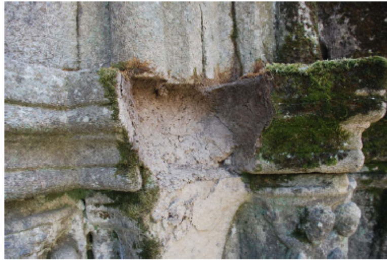
Figura 15. Aspecto del material de rejuntado degradado en la zona del capitel desprendido.
