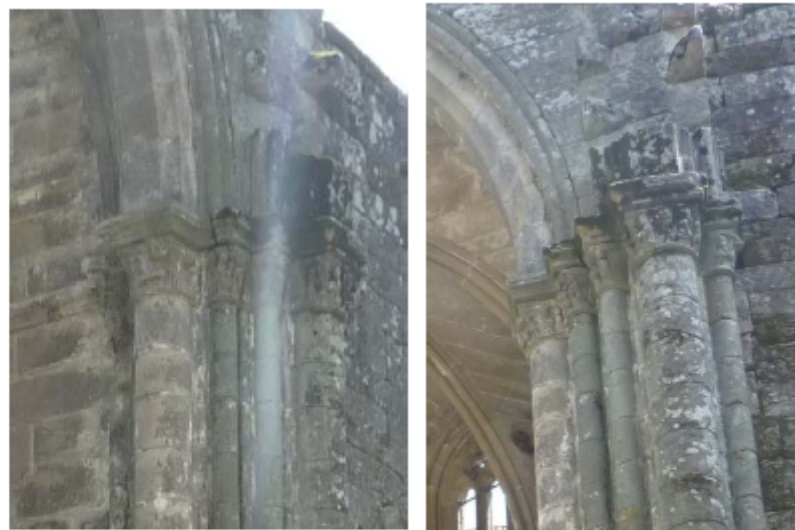
Figura 12. Imágenes del estado previo al desprendimiento del capitel.
