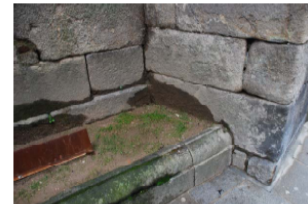
Figura 4.23. Vista del efecto de la humedad capilar y en la zona seca.
