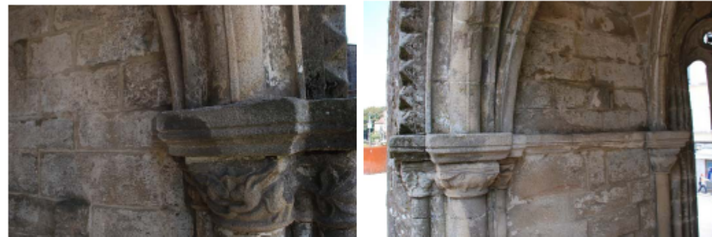
Figura 20. Falta de rejuntado de asiento entre piezas en capitel derecho e izquierdo del ábside 1.
