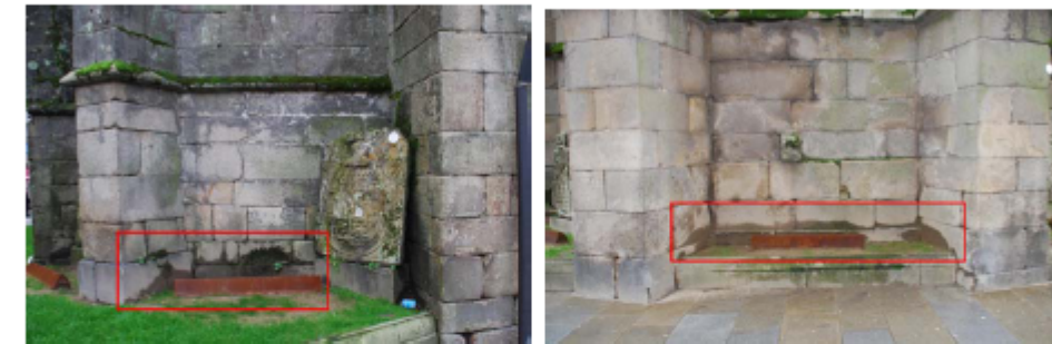
Figura 4.22. Diversas zonas de humedad capilar en la base del muro.
