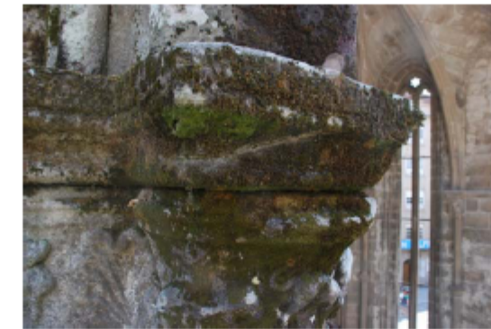
Figura 4.26. Detalle de capitel donde se aprecia la abundante presencia de musgo.
