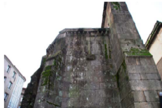
Figura 4.20. Vista de los efectos de las escorrentías en la fachada exterior.
