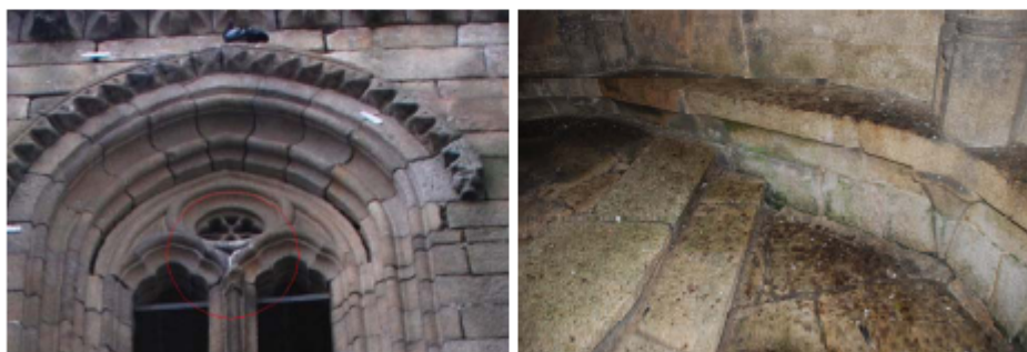
Figura 4.29. Efectos de las deposiciones de animales en ventanas y sobre la solera interior.
