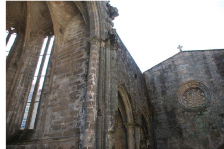
Figura 13. Estado actual del capitel desprendido.
