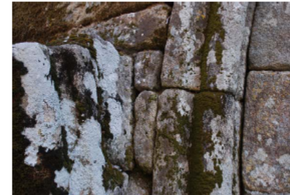
Figura 18. Falta de rejuntado entre piezas en lado izquierdo del ábside 3.
