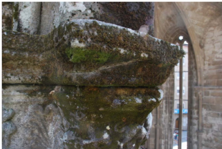
Figura 35. Detalle de capitel donde se aparecía la abundante presencia de musgo.
