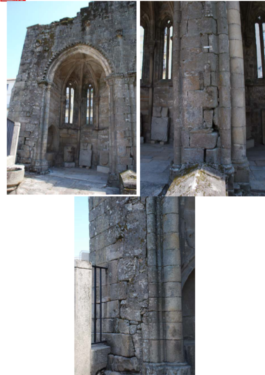
Figura 30. Imagen general y de detalle de las aberturas en los elementos de sustentación del ábside 1.
