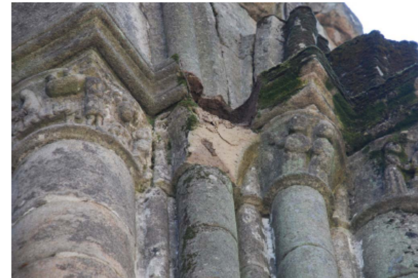
Figura 14. Vista de detalle inferior del capitel deteriorado.
