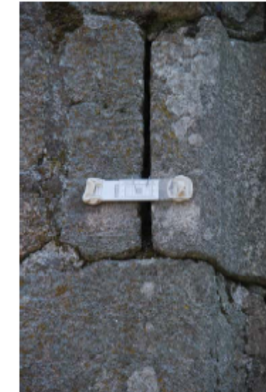
Figura 4.15. Regleta de seguimiento de aberturas en muros.
