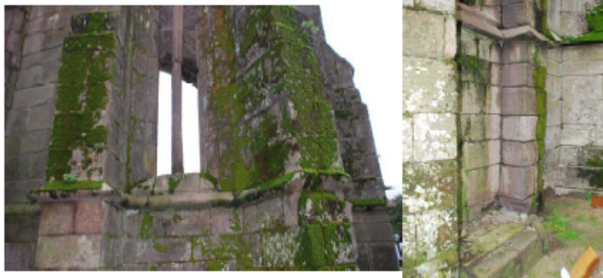
Figura 4.28. Amplias zonas afectadas por la colonización vegetal.
