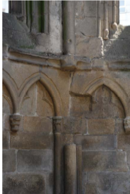
Figura 4.10. Pérdida de pilastra interior en el ábside 3.
