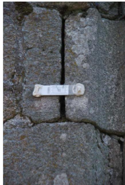
Figura 32. Regleta de seguimiento de aberturas en muros.
