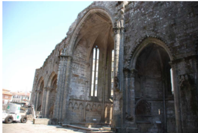
Figura 4.4. Vista interior de las ruinas de la Iglesia.
