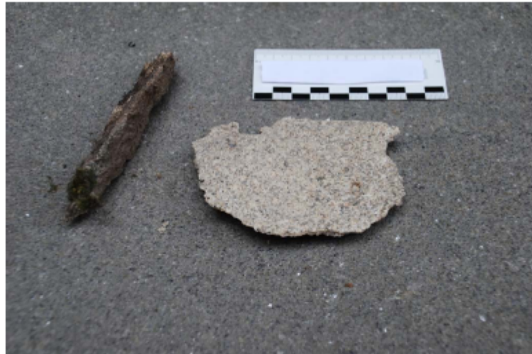
Figura 16. Laja de la superficie de rotura del capitel y material de rejuntado extraído de la zona del capitel siniestrado.
