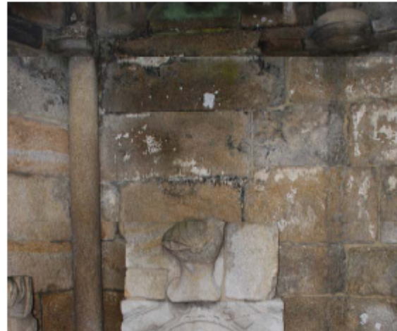
Figura 4.11. Rotura y desaparición de alero bajo ventana en interior de ábside.
