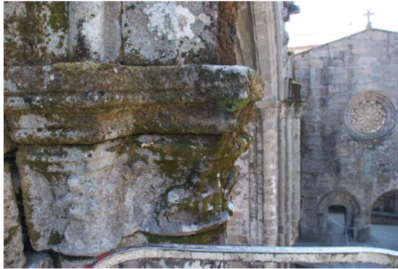
Figura 19 Falta de rejuntado de asiento entre piezas en capitel izquierdo del ábside 3.
