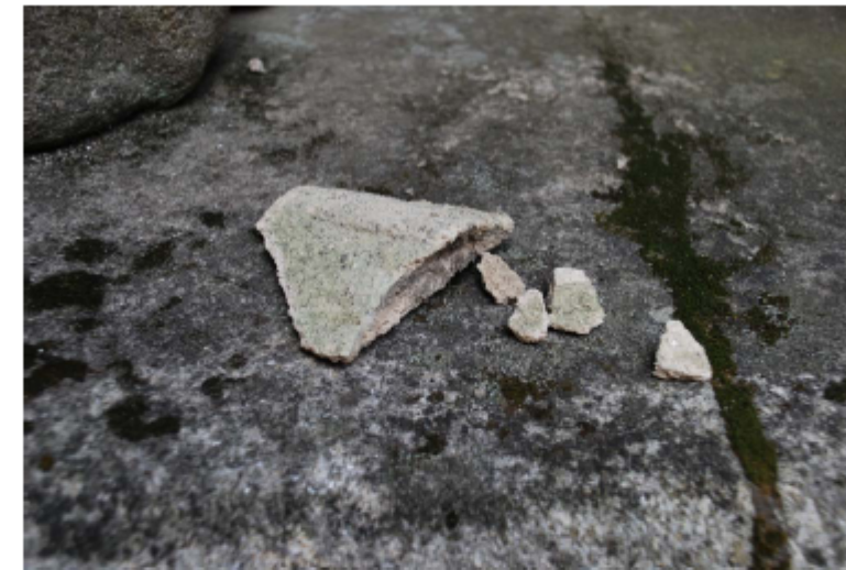
Figura 21. Secuencia del desprendimiento de una porción de rejuntado en las piezas del arco del ábside 5.
