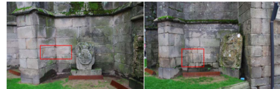
Figura 4.18. Localización en la fachada exterior de áreas con desplazación.
