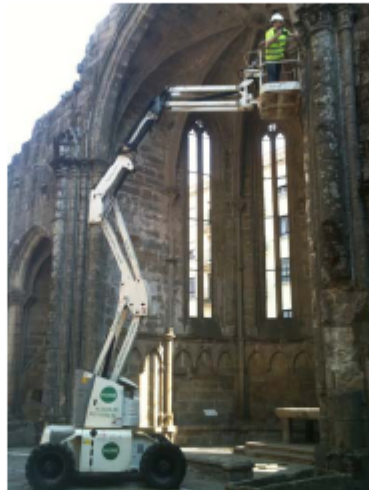
Figura 3. Inspección de la zona del capitel desprendido.
