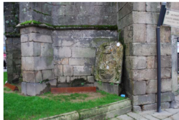
Figura 4.17. Áreas con aparición de costra negra en la cara exterior.
