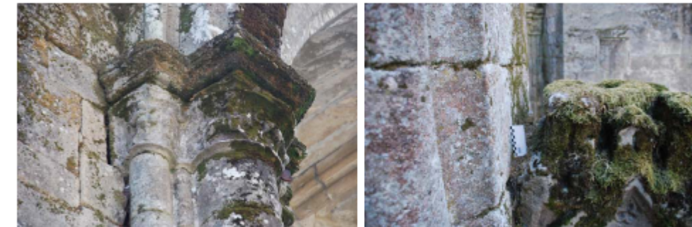
Figura 4.27. Vista de elementos colonizados por vegetación.
