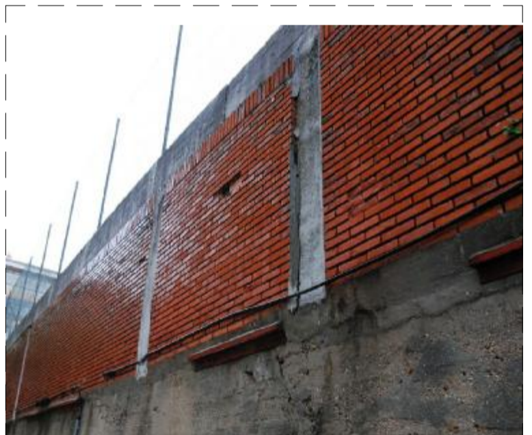
FOTO 2 UBICACIÓN: Muro H.A. en la calle Rosal. PATOLOGÍA: Despiece hacia el exterior con posibilidad de caída. CAUSAS POSIBLES: Si se desconoce siempre se pueden comprobar por los elementos metálicos colocados en la base de la presencia de la patología. REPARACIONES: Demolición y reparación de esa fachada.
