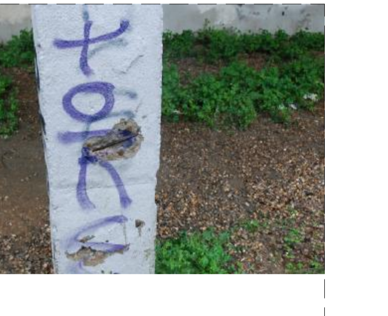
FOTO 9 UBICACIÓN: Pilar H.A. en la calle Rosal. PATOLOGÍA: Oxidación de armaduras y desprendimientos de hormigón de protección exterior. CAUSAS POSIBLES: Entrada de agua hasta la armadura con la consiguiente oxidación, hinchamiento y desprendimiento del hormigón de protección de las armaduras. REPARACIONES: Descubrir las armaduras afectadas (barras longitudinales y transversales). Limpieza, saneamiento y pasivación zonas afectadas según procedimientos de reparación marcados en plano ERO7.
