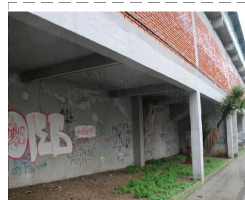
FOTO 1 UBICACIÓN: Forjado y muro de soporte. PATOLOGÍA: Filtraciones de agua desde forjado de vestuario y desde el terreno. CAUSAS POSIBLES: Perforación o rotura de impermeabilización por desajuste del acabado en las instancias de vestuario. REPARACIONES: Colocación de impermeabilización en vestuario y reparación de los acabados dañados. Si en la reparación se encuentra algún elemento estructural dañado se deberá comunicar a D.T. para que decida las medidas a ejecutar.
