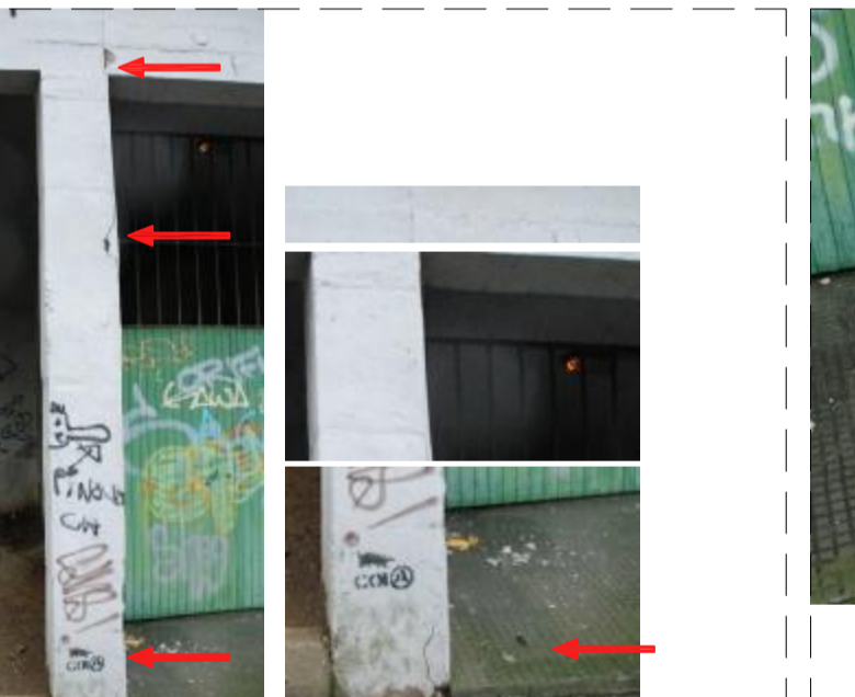
FOTO 5 UBICACIÓN: Pilar H.A. en la calle Rosal. PATOLOGÍA: Oxidación de armaduras y desprendimientos de hormigón de protección exterior. CAUSAS POSIBLES: Entrada de agua hasta la armadura con la consiguiente oxidación, hinchamiento y desprendimiento del hormigón de protección de las armaduras. REPARACIONES: Descubrir las armaduras afectadas (barras longitudinales y transversales). Limpieza, saneamiento y pasivación zonas afectadas según procedimientos de reparación marcados en plano ERO7.
