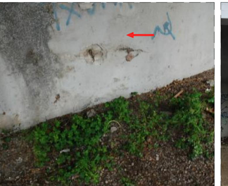
FOTO 4 UBICACIÓN: Muro H.A. en la calle Rosal. PATOLOGÍA: Oxidación de armaduras y desprendimientos de hormigón de protección exterior. CAUSAS POSIBLES: Entrada de agua hasta la armadura con la consiguiente oxidación, hinchamiento y desprendimiento del hormigón de protección de las armaduras. REPARACIONES: Descubrir las armaduras afectadas (barras longitudinales y transversales). Limpieza, saneamiento y pasivación zonas afectadas según procedimientos de reparación marcados en plano ERO7.
