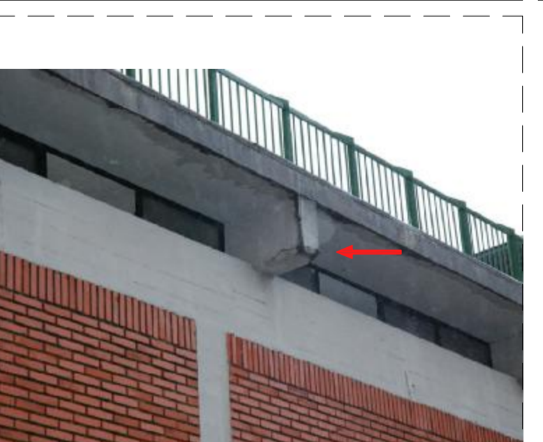
FOTO 12 UBICACIÓN: Viga H.A. en la calle Rosal. PATOLOGÍA: Oxidación de armaduras y desprendimientos de hormigón de protección exterior. CAUSAS POSIBLES: Entrada de agua hasta la armadura con la consiguiente oxidación, hinchamiento y desprendimiento del hormigón de protección de las armaduras. REPARACIONES: Descubrir las armaduras afectadas (barras longitudinales y transversales). Limpieza, saneamiento y pasivación zonas afectadas según procedimientos de reparación marcados en plano ERO7.
