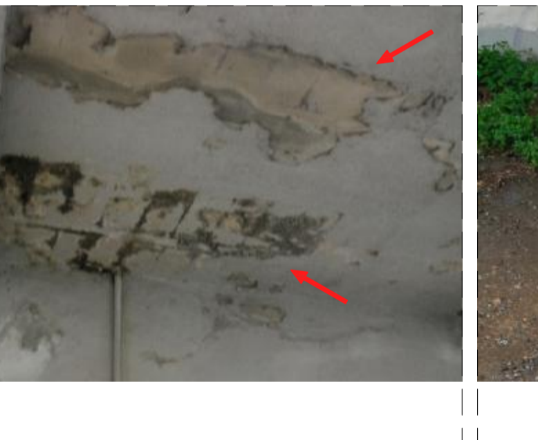
FOTO 8 UBICACIÓN: Forjado y muro de soporte. PATOLOGÍA: Filtraciones de agua desde forjado de vestuario y desde el terreno. CAUSAS POSIBLES: Perforación o rotura de impermeabilización por desajuste del acabado en las instancias de vestuario. REPARACIONES: Colocación de impermeabilización en vestuario y reparación de los acabados dañados. Si en la reparación se encuentra algún elemento estructural dañado se deberá comunicar a D.T. para que decida las medidas a ejecutar.
