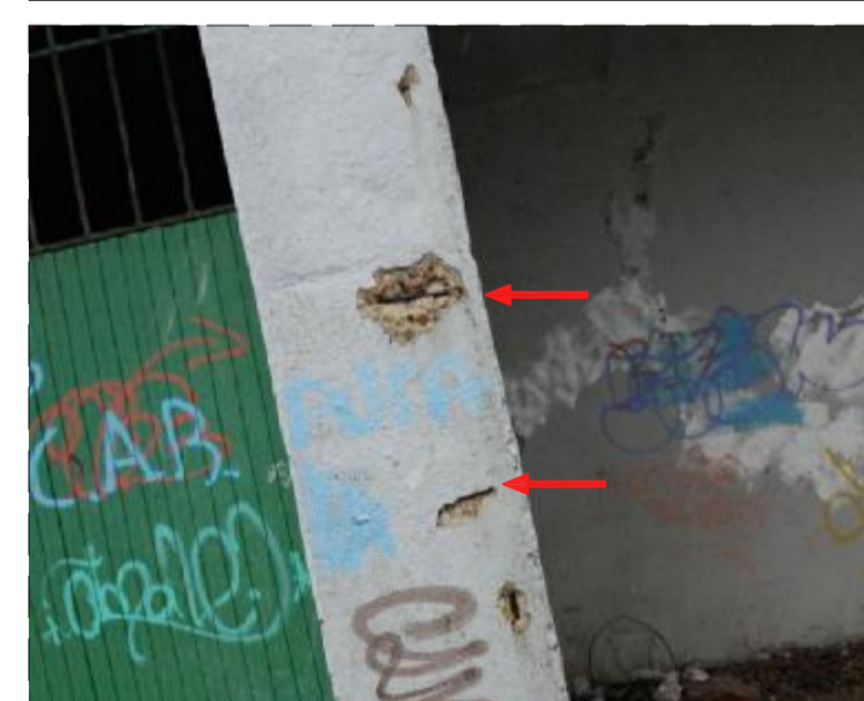
FOTO 10 UBICACIÓN: Pilar H.A. en la calle Rosal. PATOLOGÍA: Oxidación de armaduras y desprendimientos de hormigón de protección exterior. CAUSAS POSIBLES: Entrada de agua hasta la armadura con la consiguiente oxidación, hinchamiento y desprendimiento del mortero de protección de las armaduras. REPARACIONES: Descubrir las armaduras afectadas (barras longitudinales y transversales). Limpieza, saneamiento y pasivación zonas afectadas según procedimientos de reparación marcados en plano ERO7.
