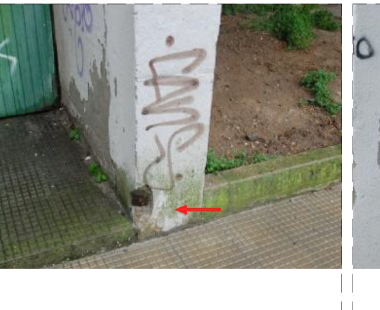
FOTO 6 UBICACIÓN: Pilar H.A. en la calle Rosal. PATOLOGÍA: Oxidación de armaduras y desprendimientos de hormigón de protección exterior. CAUSAS POSIBLES: Entrada de agua hasta la armadura con la consiguiente oxidación, hinchamiento y desprendimiento del hormigón de protección de las armaduras. REPARACIONES: Descubrir las armaduras afectadas (barras longitudinales y transversales). Limpieza, saneamiento y pasivación zonas afectadas según procedimientos de reparación marcados en plano ERO7.
