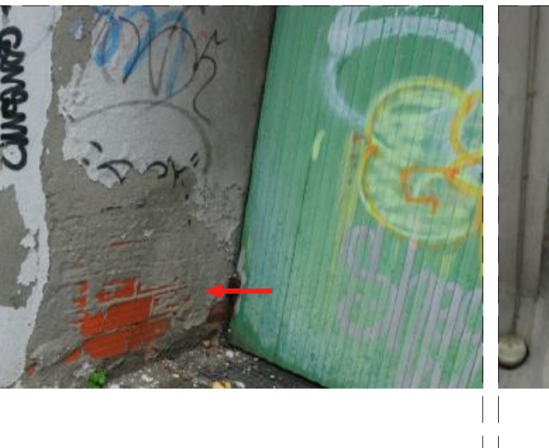
FOTO 7 UBICACIÓN: Muro de fábrica de ladrillo en escaleras de acceso desde la calle Rosal. PATOLOGÍA: Desprendimiento de revoco de cemento y acabado superficial. CAUSAS POSIBLES: Situación expuesta a cambios climáticos (húmedad, cambios de temperaturas e impactos). REPARACIONES: Limpieza de todo el mortero y pintura que esté mal adherido para la posterior ejecución del acabado descrito en proyecto.
