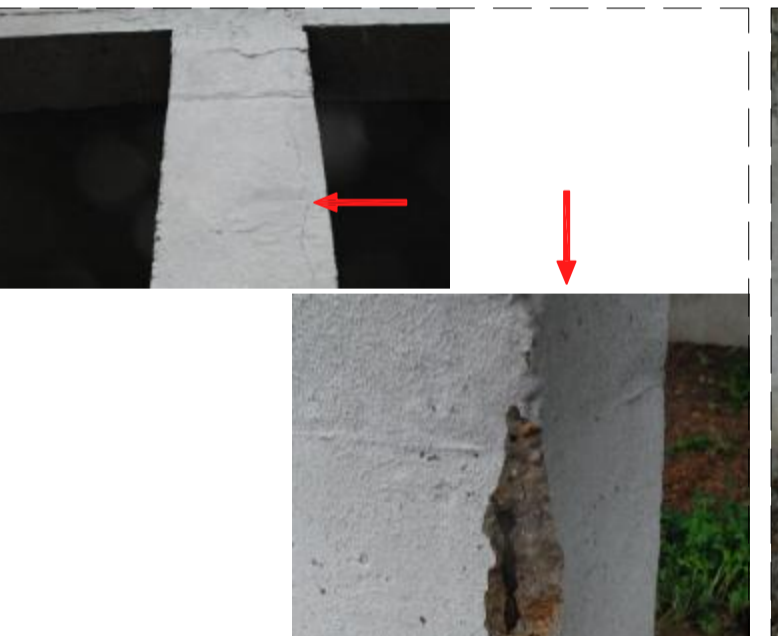
FOTO 3a y 3b UBICACIÓN: Pilar H.A. en la calle Rosal. PATOLOGÍA: Oxidación de armaduras y desprendimientos de hormigón de protección exterior. CAUSAS POSIBLES: Entrada de agua hasta la armadura con la consiguiente oxidación, hinchamiento y desprendimiento del hormigón de protección de las armaduras. REPARACIONES: Descubrir las armaduras afectadas (barras longitudinales y transversales). Limpieza, saneamiento y pasivación zonas afectadas según procedimientos de reparación marcados en plano ERO7.
