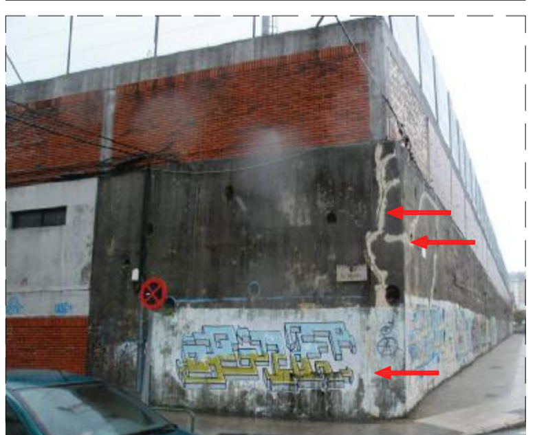
FOTO 11 UBICACIÓN: Muro H.A. en la calle Rosal. PATOLOGÍA: Grietas que recorren todo el muro de contención en altura. CAUSAS POSIBLES: Si se desconoce la causa dada la poca información del elemento y su ejecución pero se deduce por los muros dañados en su totalidad que se ha producido hace tiempo. REPARACIONES: Descubrir las armaduras afectadas (barras longitudinales y transversales). Limpieza, saneamiento y pasivación zonas afectadas según procedimientos de reparación marcados en plano ERO7.
