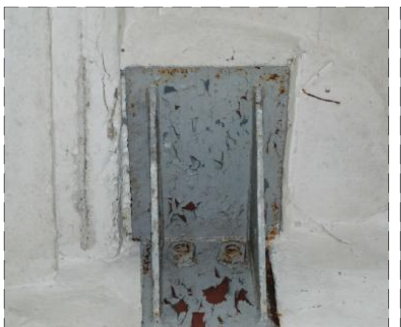
FOTO 25 UBICACIÓN: Vestuario 3. Tabique de Acceso. Mensulas metálicas de apoyo para estructura de cubierta metálica existente. PAATOLOGÍA: Oxidación. CAUSAS POSIBLES: Ambiente húmedo y agresivo y falta de mantenimiento. REPARACIONES: Limpieza de la capa de óxido por medios mecánicos y aplicación de tratamiento pasivante y protector.
