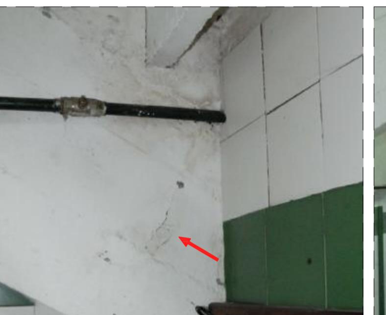
FOTO 28 UBICACIÓN: Vestuario 3. Viga Zanca nº 7. PAATOLOGÍA: Oxidación de armaduras y desplazamientos de hormigón de protección exterior. CAUSAS POSIBLES: Entrada de agua hacia la armadura con la consiguiente oxidación, hinchamiento y desplazamiento del hormigón de protección de las armaduras. REPARACIONES: Descubrir las armaduras afectadas (barras longitudinales y transversales). Limpieza, saneamiento y pasivación de zonas afectadas según procedimientos de reparación marcados en plano ERO7.
