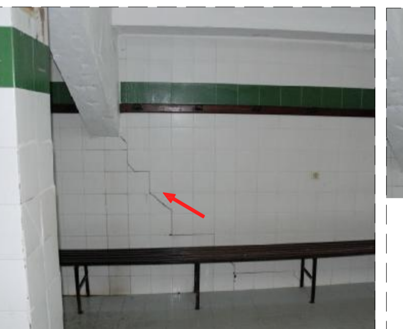
FOTO 38 UBICACIÓN: Vestuario 4. Tabique de cierre con grados. PAATOLOGÍA: Grúa que recorre el tabique desde la altura donde atraviesa la viga zanca y desciende entre las juntas del alcañal hasta la parte inferior del revolo del vano. CAUSAS POSIBLES: Entrada de agua hacia la armadura con la consiguiente oxidación, hinchamiento y desplazamiento del hormigón de protección de las armaduras. REPARACIONES: Levantamiento del alcañal y mortero. Cuido del tabique en la zona dañada y reposición de mortero. Colocación del nuevo acabado superficial.
