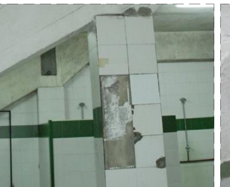
FOTO 29 UBICACIÓN: Pizar H.A. Portico II. PAATOLOGÍA: Desplazamiento de alcañales y posible Oxidación de armaduras y desplazamientos de hormigón de protección exterior. CAUSAS POSIBLES: Entrada de agua hacia la armadura con la consiguiente oxidación, hinchamiento y desplazamiento del hormigón de protección de las armaduras. REPARACIONES: Descubrir las armaduras afectadas (barras longitudinales y transversales). Limpieza, saneamiento y pasivación de zonas afectadas según procedimientos de reparación marcados en plano ERO7.
