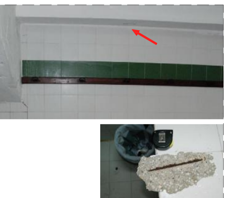
FOTO 39 UBICACIÓN: Vestuario 4. Gratas prefabricadas de hormigón armado. PAATOLOGÍA: Oxidación de armaduras y desplazamientos de hormigón de protección exterior. CAUSAS POSIBLES: Entrada de agua hacia la armadura con la consiguiente oxidación, hinchamiento y desplazamiento del hormigón de protección de las armaduras. REPARACIONES: Descubrir las armaduras afectadas (barras longitudinales y transversales). Limpieza, saneamiento y pasivación de zonas afectadas según procedimientos de reparación marcados en plano ERO7.
