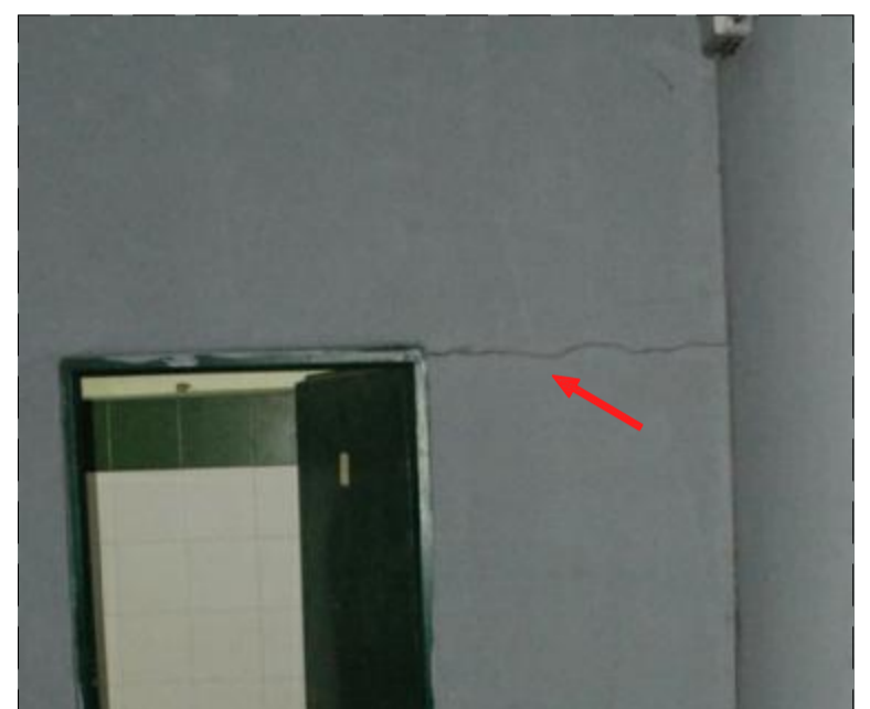
FOTO 24 UBICACIÓN: Vestuario 3. Tabique de Acceso. PAATOLOGÍA: Grúa que recorre el tabique desde el dintel de la puerta a la cara inferior del forjado superior atravesando todo el tabique. En la parte inferior donde está alcalado se prolonga en las juntas de los alcañales 1. Labios con separación constante y ambos en el mismo plano. CAUSAS POSIBLES: Deformación estructural de la estructura. La grúa parece que no está activa. REPARACIONES: Levantamiento del alcañal y mortero. Cuido del tabique en la zona dañada y reposición de mortero. Colocación del nuevo acabado superficial.
