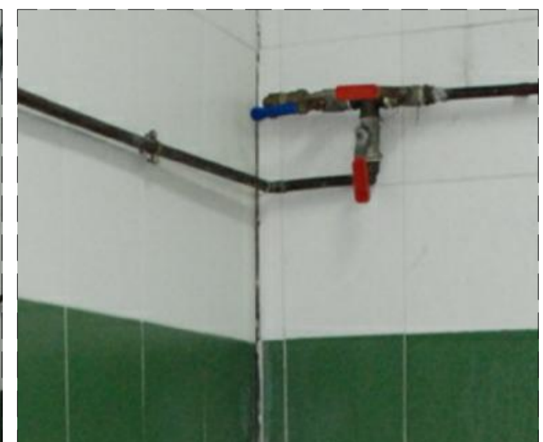
FOTO 23 UBICACIÓN: Vestuario árbitro 2. Tabique interior de separación con vestuario 3. PAATOLOGÍA: Grúa que recorre el tabique desde el dintel de la puerta a la cara inferior del forjado superior atravesando todo el tabique. En la parte inferior donde está alcalado se prolonga en las juntas de los alcañales 1. Labios con separación constante y ambos en el mismo plano. CAUSAS POSIBLES: Deformación estructural de la estructura. La grúa parece que no está activa. REPARACIONES: Levantamiento del alcañal y mortero. Cuido del tabique en la zona dañada y reposición de mortero. Colocación del nuevo acabado superficial.
