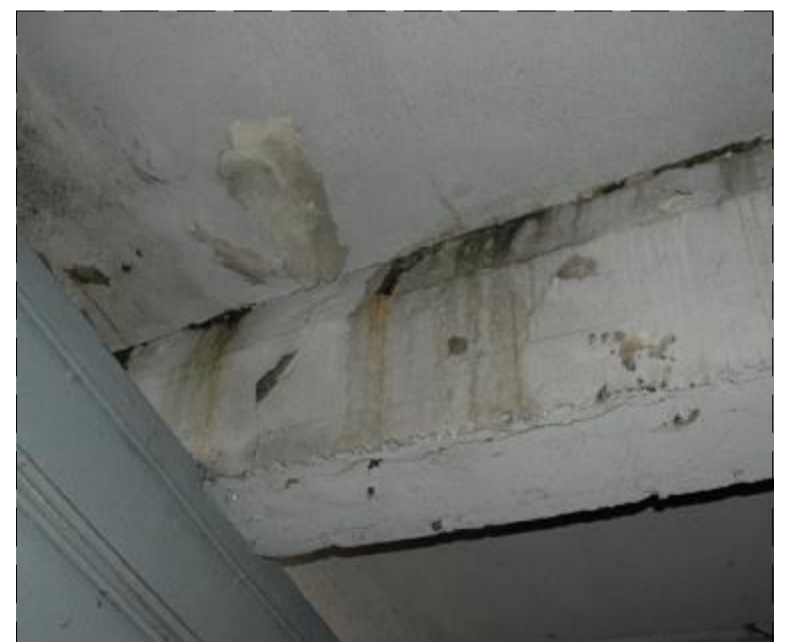
FOTO 33 UBICACIÓN: Acceso a Vestuario 3 y 4. Viga Zanca nº 5. PAATOLOGÍA: Oxidación de armaduras y desplazamientos de hormigón de protección exterior. CAUSAS POSIBLES: Entrada de agua hacia la armadura con la consiguiente oxidación, hinchamiento y desplazamiento del hormigón de protección de las armaduras. REPARACIONES: Descubrir las armaduras afectadas (barras longitudinales y transversales). Limpieza, saneamiento y pasivación de zonas afectadas según procedimientos de reparación marcados en plano ERO7.
