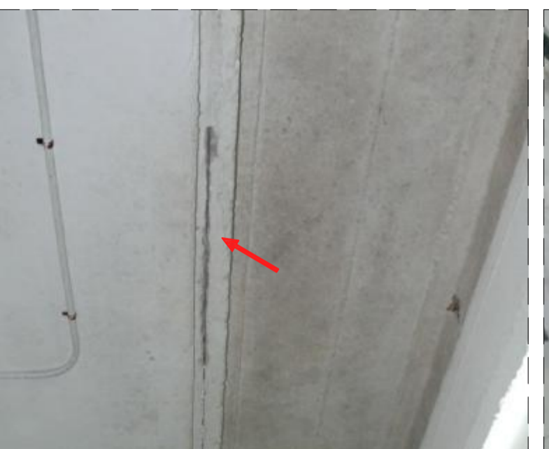
FOTO 26 UBICACIÓN: Gratas prefabricadas de H.A. PAATOLOGÍA: Oxidación de armaduras y desplazamientos de hormigón de protección exterior. CAUSAS POSIBLES: Entrada de agua hacia la armadura con la consiguiente oxidación, hinchamiento y desplazamiento del hormigón de protección de las armaduras. REPARACIONES: Descubrir las armaduras afectadas (barras longitudinales y transversales). Limpieza, saneamiento y pasivación de zonas afectadas según procedimientos de reparación marcados en plano ERO7.
