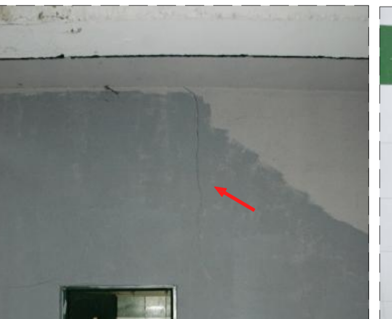
FOTO 37 UBICACIÓN: Vestuario 4. Tabique de Acceso. PAATOLOGÍA: Grúa que recorre el tabique desde el dintel de la puerta a la cara inferior del forjado superior atravesando todo el tabique. En la parte inferior donde está alcalado se prolonga en las juntas de los alcañales 1. Labios con separación constante y ambos en el mismo plano. CAUSAS POSIBLES: Deformación estructural de la estructura. La grúa parece que no está activa. REPARACIONES: Levantamiento del alcañal y mortero. Cuido del tabique en la zona dañada y reposición de mortero. Colocación del nuevo acabado superficial.
