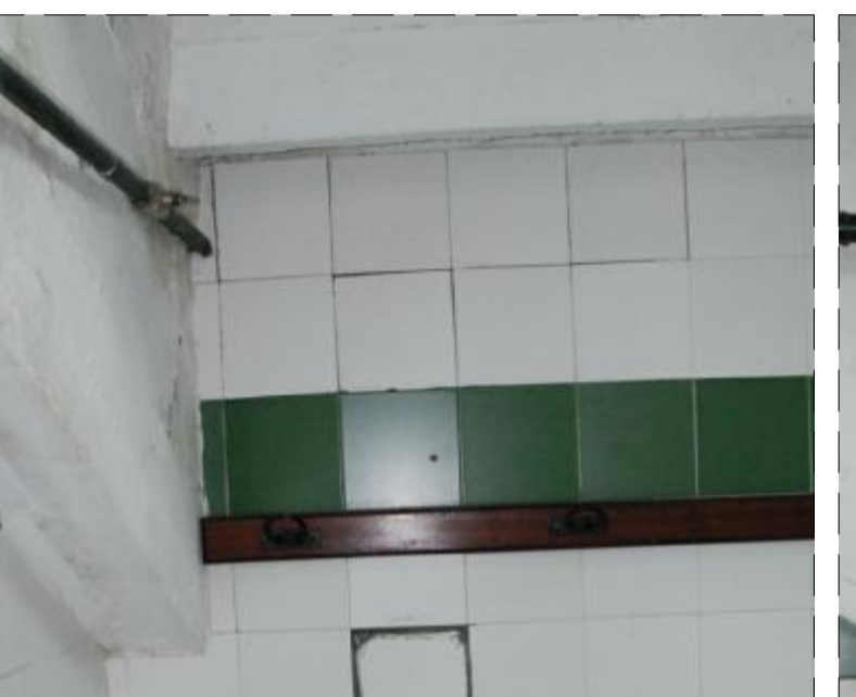
FOTO 27 UBICACIÓN: Tabique de cierre con parte inferior de grados. PAATOLOGÍA: Levantamiento de alcañales de pared. CAUSAS POSIBLES: Entrada de humedad por la fachada exterior que provoca la falta de adherencia con el mortero con la que se ha adherido a la tabiquería. REPARACIONES: Levantamiento del alcañal y ejecución de una hoja inferior de fábrica de ladrillo.
