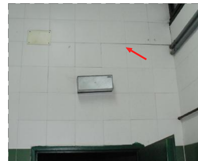
FOTO 22 UBICACIÓN: Vestuario árbitro 2. Tabique de acceso. PAATOLOGÍA: Grúa que recorre el tabique desde el dintel de la puerta a la cara inferior del forjado superior atravesando todo el tabique. En la parte inferior donde está alcalado se prolonga en las juntas de los alcañales 1. Labios con separación constante y ambos en el mismo plano. CAUSAS POSIBLES: Deformación estructural de la estructura. La grúa parece que no está activa. REPARACIONES: Levantamiento del alcañal y mortero. Cuido del tabique en la zona dañada y reposición de mortero. Colocación del nuevo acabado superficial.
