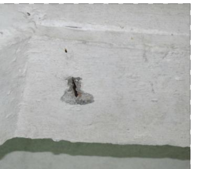
FOTO 30 UBICACIÓN: Vestuario 3. Portico II. PAATOLOGÍA: Oxidación de armaduras y desplazamientos de hormigón de protección exterior. CAUSAS POSIBLES: Entrada de agua hacia la armadura con la consiguiente oxidación, hinchamiento y desplazamiento del hormigón de protección de las armaduras. REPARACIONES: Descubrir las armaduras afectadas (barras longitudinales y transversales). Limpieza, saneamiento y pasivación de zonas afectadas según procedimientos de reparación marcados en plano ERO7.
