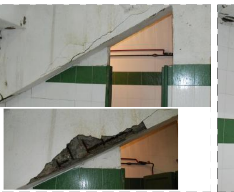
FOTO 45 UBICACIÓN: Vestuario 6. Viga Zanca Eje 2. PATOLOGIA: Oxidación de armaduras y desplazamientos de hormigón de protección exterior. CAUSAS POSIBLES: Entrada de agua hacia la armadura con la consiguiente oxidación, hinchamiento y desplazamiento del hormigón de protección de las armaduras. REPARACIONES: Descubierto las armaduras afectadas (barras longitudinales y transversales). Limpieza, saneamiento y pasivación de zonas afectadas según procedimientos de reparación marcados en plano E907. Estimar la pérdida de acero en este caso dada la gravedad de la oxidación.
