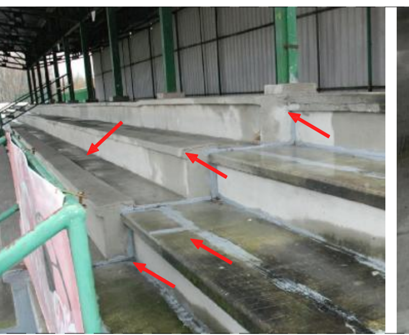
4. Grietas y fisuras en los apoyos con las vigas zanca de hormigón armado. 5. Bajo grado de agere o rugosidad. 6. Oxidación de las armaduras de los gradas a provocado el hinchamiento de los barras y con el ello el desplazamiento del hormigón de protección o superficial. 7. El sistema de encaje de las barandillas tan próximos al extremo de los elementos prefabricados ha generado la rotura de los mismos. 8. Morteros de protección de placas bases de pilares, están fracturados por lo que se supone una oxidación de la misma.
