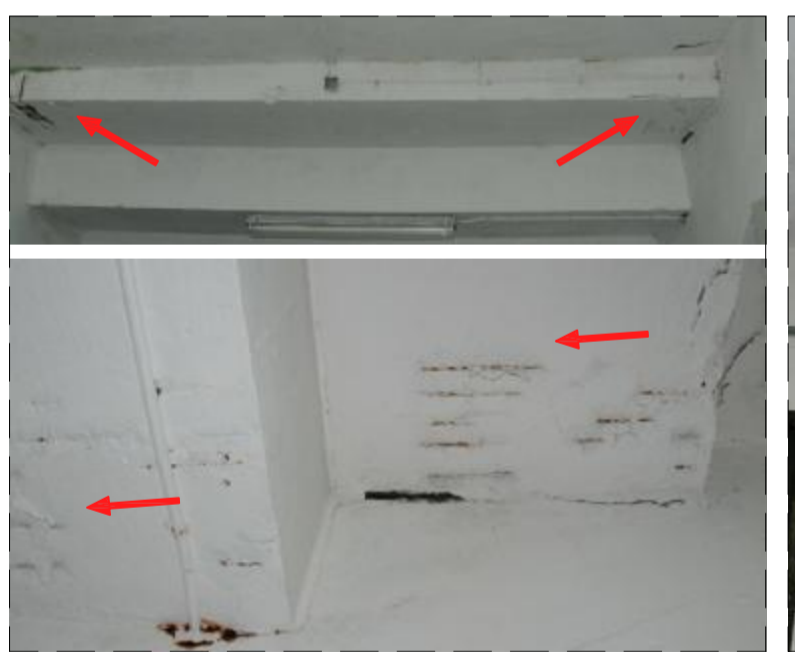
FOTO 42 UBICACIÓN: Vestuario 4. Zancas sobre vestuario. PATOLOGIA: Oxidación de armaduras y desplazamientos de hormigón de protección exterior. CAUSAS POSIBLES: Entrada de agua hacia la armadura con la consiguiente oxidación, hinchamiento y desplazamiento del hormigón de protección de las armaduras. REPARACIONES: Descubierto las armaduras afectadas (barras longitudinales y transversales). Limpieza, saneamiento y pasivación de zonas afectadas según procedimientos de reparación marcados en plano E907.
