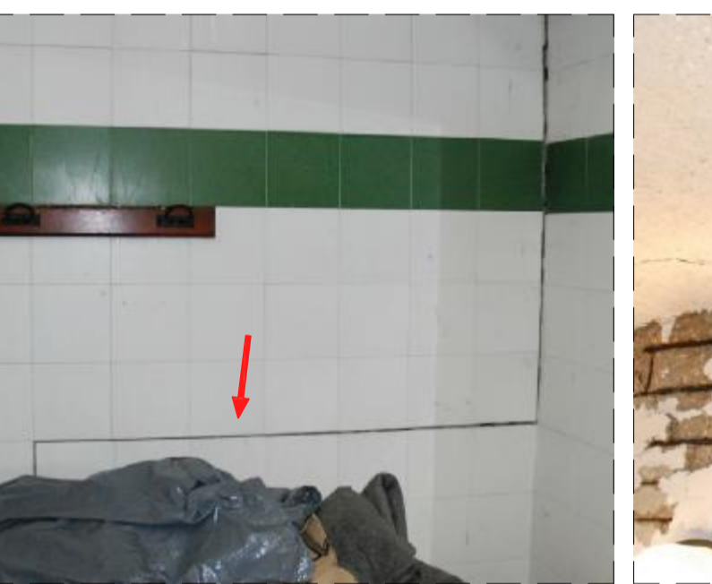
FOTO 47 UBICACIÓN: Vestuario 6. Tabique de cierre de vestuario en eje 1. PATOLOGIA: Grietas que recorren el tabique desde el dintel de la ventana hasta las esquinas. La grieta discurre entre las juntas del alicato. CAUSAS POSIBLES: Deformación excesiva de la estructura. La grieta parece que no está activa. REPARACIONES: Descubierto las armaduras afectadas (barras longitudinales y transversales). Limpieza, saneamiento y pasivación de zonas afectadas según procedimientos de reparación marcados en plano E907.
