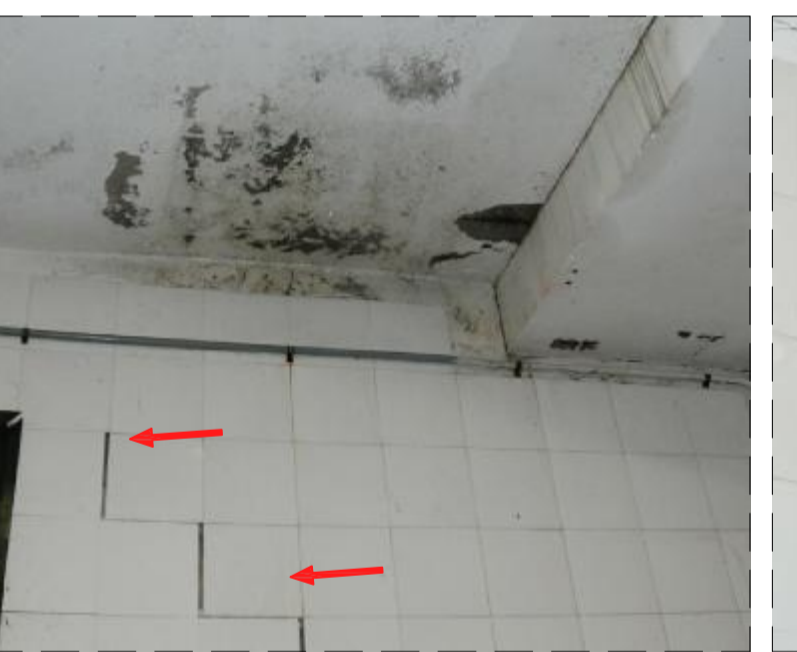
FOTO 43 UBICACIÓN: Vestuario 6. Tabique de cierre de vestuario en eje 1. PATOLOGIA: Grietas que recorren el tabique desde el dintel de la ventana hasta las esquinas. La grieta discurre entre las juntas del alicato. CAUSAS POSIBLES: Deformación excesiva de la estructura. La grieta parece que no está activa. REPARACIONES: Levantamiento del alicato y mortero. Colado del tabique en la zona dañada y reposición de mortero. Colocación del nuevo acabado superficial.
