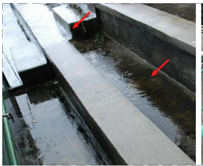
FOTOS 51-52-53 PATOLOGIAS EXTERIORES EN GRADAS: Las zonas más afectadas de las gradas son las zonas extremas que se encuentran descubiertas y con ello con una mayor exposición a los agentes externos. Dentro de la problemática que hemos encontrado en líneas generales en los siguientes tipos. 1. Dintelos ligeros de gradas prefabricadas que vienen de las sucesivas reformas o ampliaciones que se han producido generando encuentros sin resolver y acumulación de aguas en salidas. 2. Falta de impermeabilización y sellado entre las distintas piezas. 3. Montaje de algunas piezas que genera la acumulación de agua a lo largo de toda la parte interior de los pies. Siendo la única posibilidad de desaparición la absorción por parte del hormigón y su evaporación por el ambiente.
