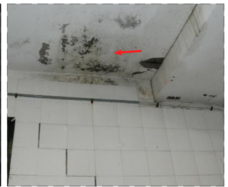
FOTO 50 UBICACIÓN: Vestuario 6. Gradas que forman la cubierta. PATOLOGIA: Humedades por filtración de agua al interior. CAUSAS POSIBLES: Ausencia de impermeabilización y mal sellado entre piezas. REPARACIONES: Reposar el recubrimiento perdido.
