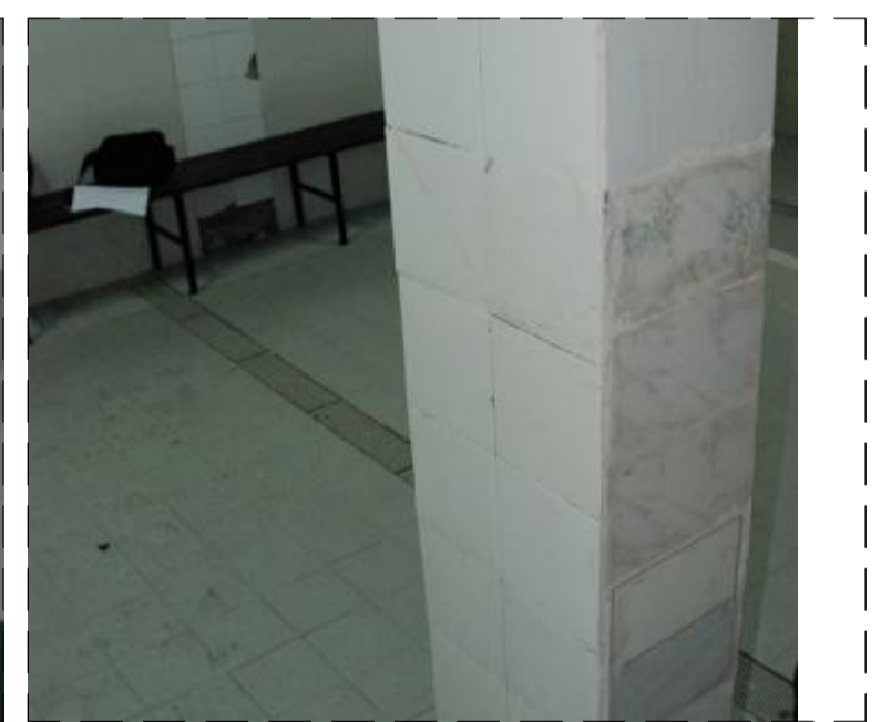
FOTO 41 UBICACIÓN: Vestuario 4. Pizar H.A. Partido 4. PATOLOGIA: Desprendimiento de alicatos y posible oxidación de armaduras y desplazamientos de hormigón de protección exterior. CAUSAS POSIBLES: Oxidación de armaduras y desplazamientos de hormigón de protección exterior. REPARACIONES: Descubierto las armaduras afectadas (barras longitudinales y transversales). Limpieza, saneamiento y pasivación de zonas afectadas según procedimientos de reparación marcados en plano E907.
