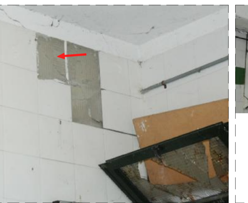
FOTO 44 UBICACIÓN: Vestuario 6. Tabique de cierre con gradas. PATOLOGIA: Grietas que recorren el tabique desde el dintel de la ventana hasta las esquinas. La grieta discurre entre las juntas del alicato. CAUSAS POSIBLES: Deformación excesiva de la estructura. La grieta parece que no está activa. REPARACIONES: Levantamiento del alicato y mortero. Colado del tabique en la zona dañada y reposición de mortero. Colocación del nuevo acabado superficial.
