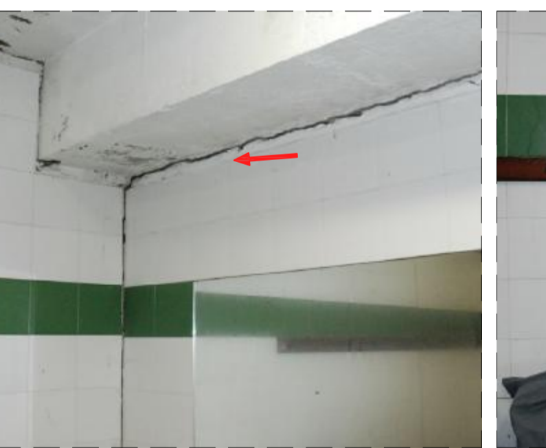
FOTO 46 UBICACIÓN: Vestuario 6. Tabique de cierre con gradas. PATOLOGIA: Grietas que recorren el tabique desde el dintel de la ventana hasta las esquinas. La grieta discurre entre las juntas del alicato. CAUSAS POSIBLES: Deformación excesiva de la estructura. La grieta parece que no está activa. REPARACIONES: Descubierto las armaduras afectadas (barras longitudinales y transversales). Limpieza, saneamiento y pasivación de zonas afectadas según procedimientos de reparación marcados en plano E907. Estimar la pérdida de acero en este caso dada la gravedad de la oxidación.
