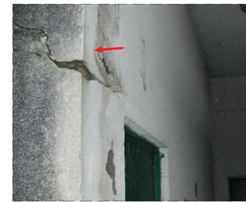
FOTO 49 UBICACIÓN: Vestuario 6. Acceso desde el exterior. PATOLOGIA: Grietas. CAUSAS POSIBLES: Por empuje/desplazamiento de la estructura o impacto. REPARACIONES: Replicado de la zona afectada para coser y reparar con mortero y acabado exterior.
