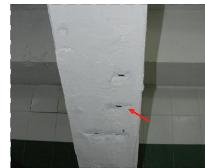
FOTO 40 UBICACIÓN: Vestuario árbitros 4. Viga Zanca Eje 4. PATOLOGIA: Oxidación de armaduras y desplazamientos de hormigón de protección exterior. CAUSAS POSIBLES: Entrada de agua hacia la armadura con la consiguiente oxidación, hinchamiento y desplazamiento del hormigón de protección de las armaduras. REPARACIONES: Descubierto las armaduras afectadas (barras longitudinales y transversales). Limpieza, saneamiento y pasivación de zonas afectadas según procedimientos de reparación marcados en plano E907.
