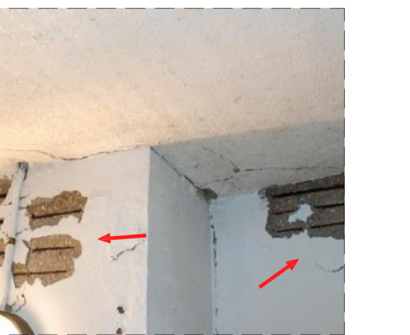
FOTO 48 UBICACIÓN: Vestuario 6. Gradas prelabradas de H.A. PATOLOGIA: Oxidación de armaduras y desplazamientos de hormigón de protección exterior. CAUSAS POSIBLES: Entrada de agua hacia la armadura con la consiguiente oxidación, hinchamiento y desplazamiento del hormigón de protección de las armaduras. REPARACIONES: Descubierto las armaduras afectadas (barras longitudinales y transversales). Limpieza, saneamiento y pasivación de zonas afectadas según procedimientos de reparación marcados en plano E907.
