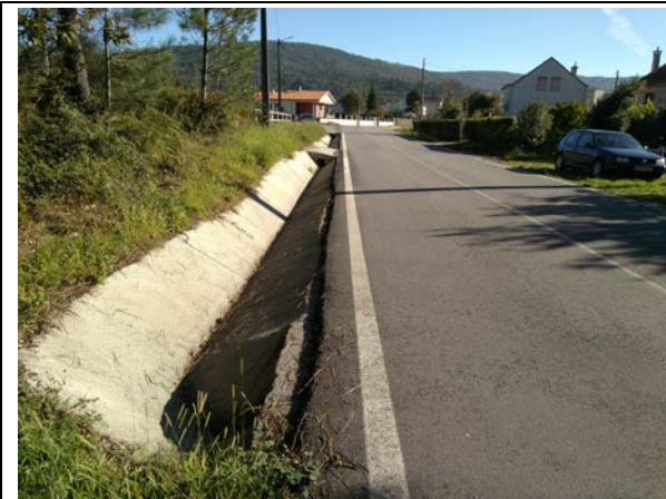
Vista de la cuneta revestida existente por el margen izquierdo de la EP-8703 al inicio de la actuación
