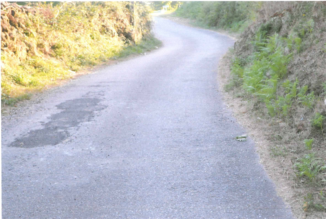
REBOREDO – CAMINO. Tramo final del mismo camino.
