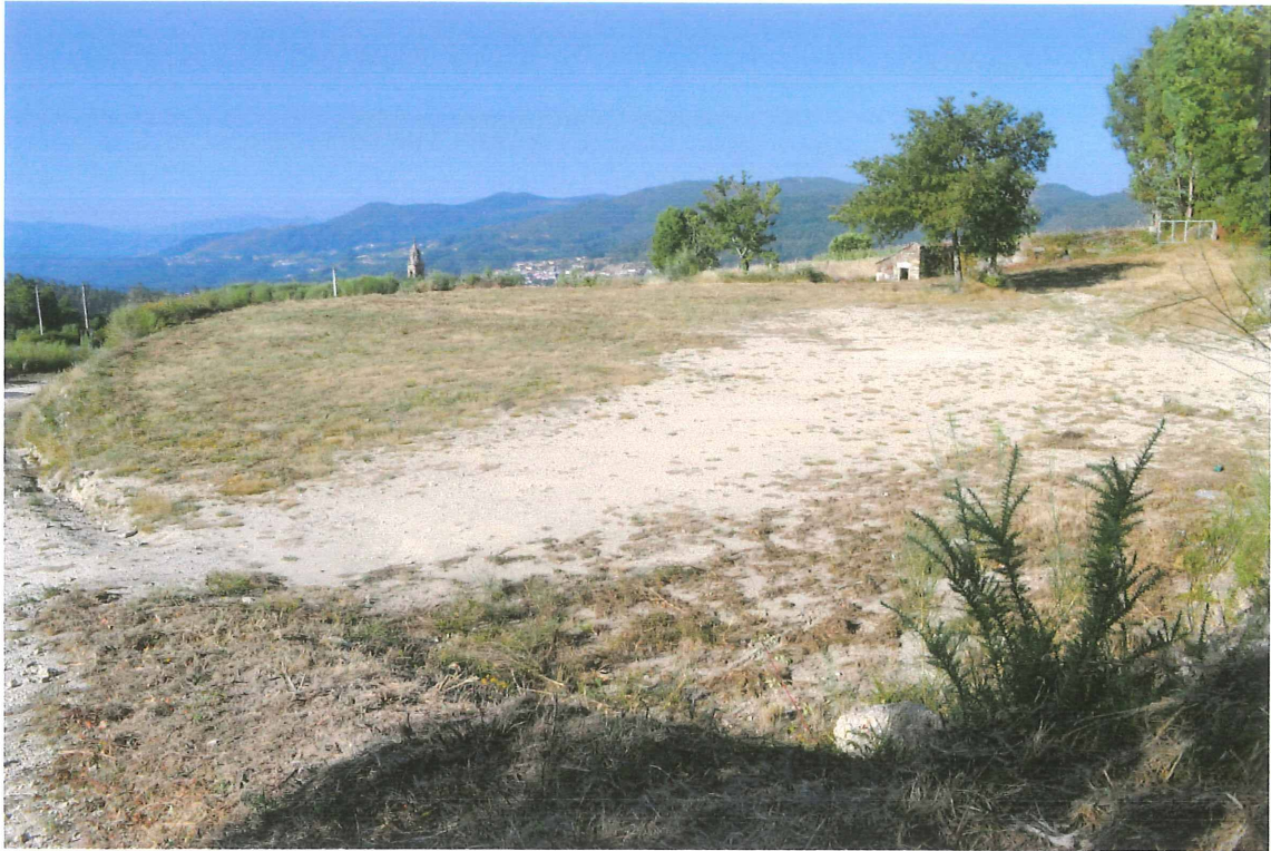
MUIMENTA – APARCAMIENTO. Zona del aparcamiento a construir con material granular, tipo zahorra artificial. A la izquierda se observa el camino proyectado.
