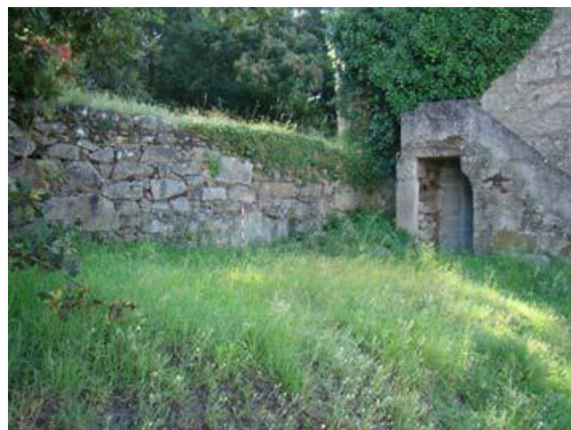
Dous aspectos dos muros afectados
