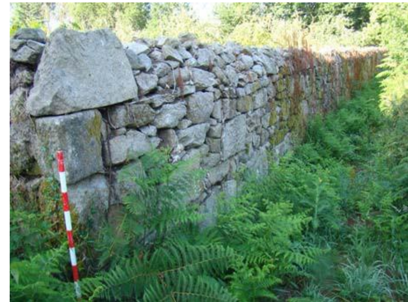
Zona do peche afectada. Cara Norte
