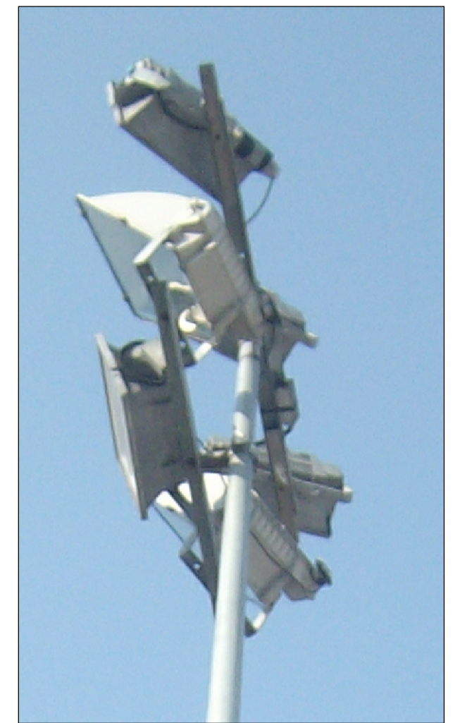
DETALLE LUMINARIAS EXISTENTES
